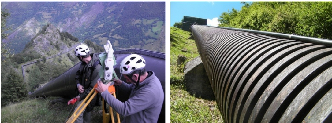
Figure 10 - levé topographique de la conduite (à gauche) en crête et tronçon de conduite en tranchée forestière (à droite)
