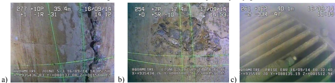
Figure 7 – Prises de vues lors de l'examen subaquatique a) Arrêtes de joint irrégulières (défaut de construction) b) Nid de cailloux c) Grilles de la prise d'eau
